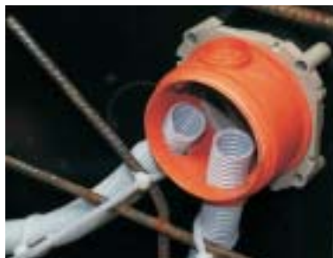
Tubos flexibles instalados en el cuerpo KBT.
